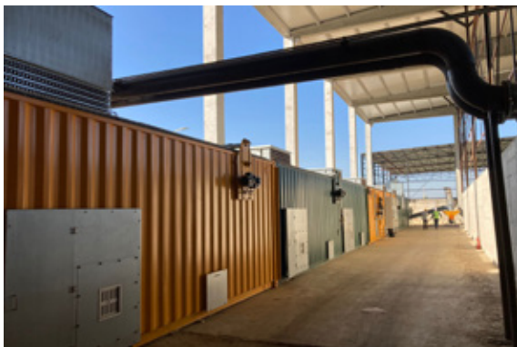
Referenzanlage: Türkei, 2022 RDF-Trocknung / 7.500 kg/h
