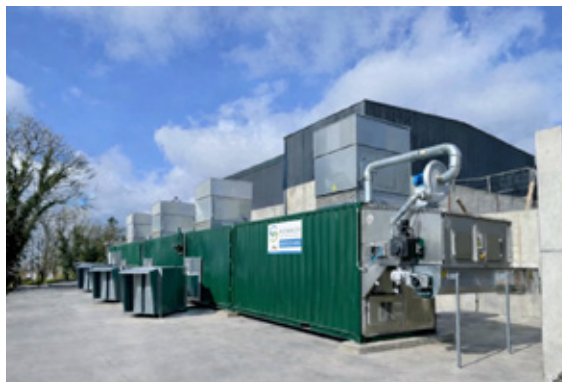
Referenzanlage: Nordirland, 2026 Sägespäne-Trocknung / 4.000 kg/h
